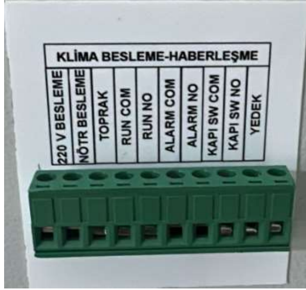
Şekil 3. Klima üzerinde Kablolamaların yapıldığı Klemensler ve Açıklamaları
